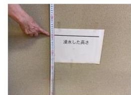
【建物内部の浸水した深さを撮る …近景】
