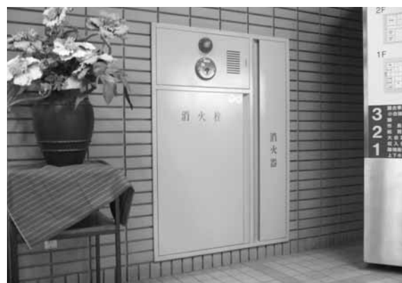
合志庁舎屋内消火栓
