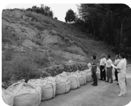
立割菰迫線(路肩崩壊)
