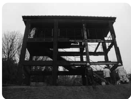
（現地調査） 飯高山展望台火災現場
