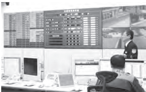
消防車両の現在位置などが表示される表示盤と光回線で通信可能な指令台
