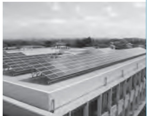
西合志中学校の太陽光発電設備
