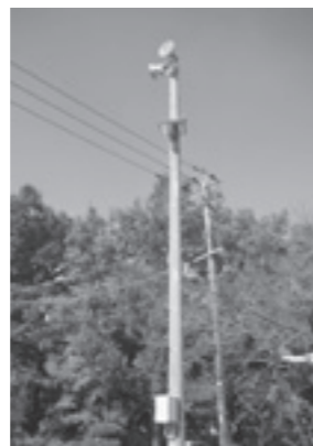
東大池区の屋外スピーカー
