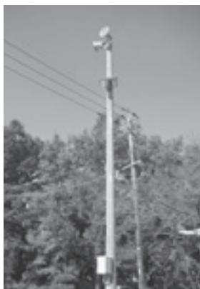
東大池区の屋外スピーカー
