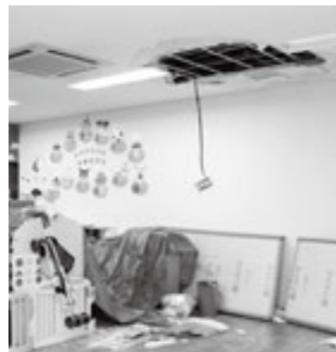
館内のいたる所で配管が破裂し天井が崩落した（写真は保育室）
