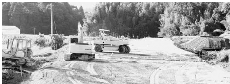
スマートインターチェンジの工事は順調に進んでおり、交通の利便性の高まりが期待されます
