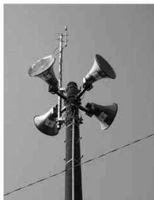
江良区の放送設備
