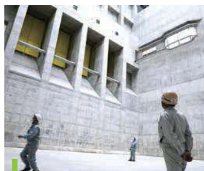
空のごみピット内。ゴミが搬入される前の貴重な光景で、黄色の扉からピット内にゴミが投入される
