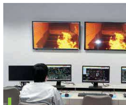
施設全体を管理する中央制御室。ここでゴミの搬入や焼却炉内部、ごみピット内のようすを確認する
