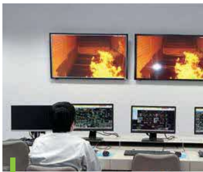
施設全体を管理する中央制御室。ここでごみの搬入や焼却炉内部、ごみピット内のようすを確認する
