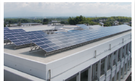
西合志中学校に設置された太陽光パネル
