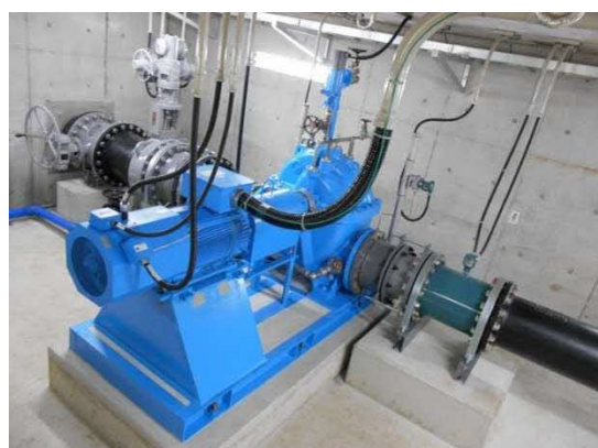
小水力発電 (戸島送水場)
